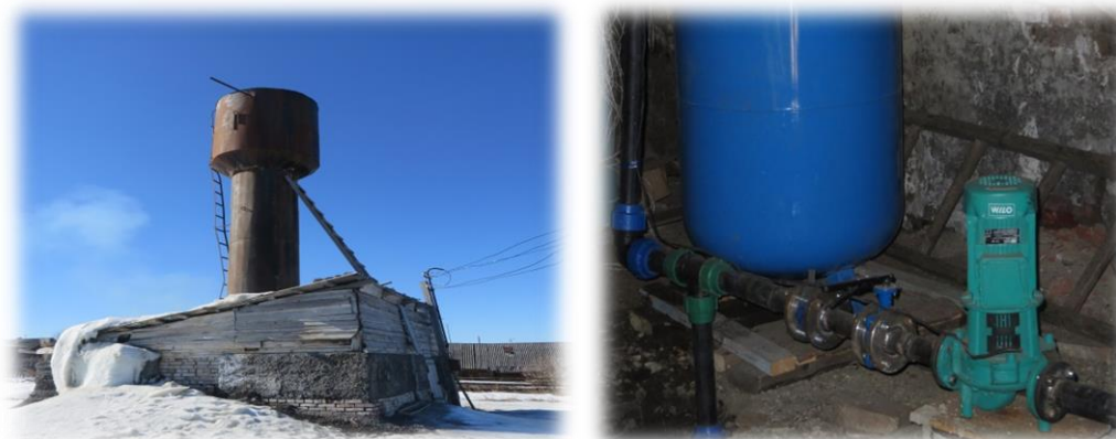
Рисунок 10. Скважина централизованного водоснабжения с.Кишкинское
