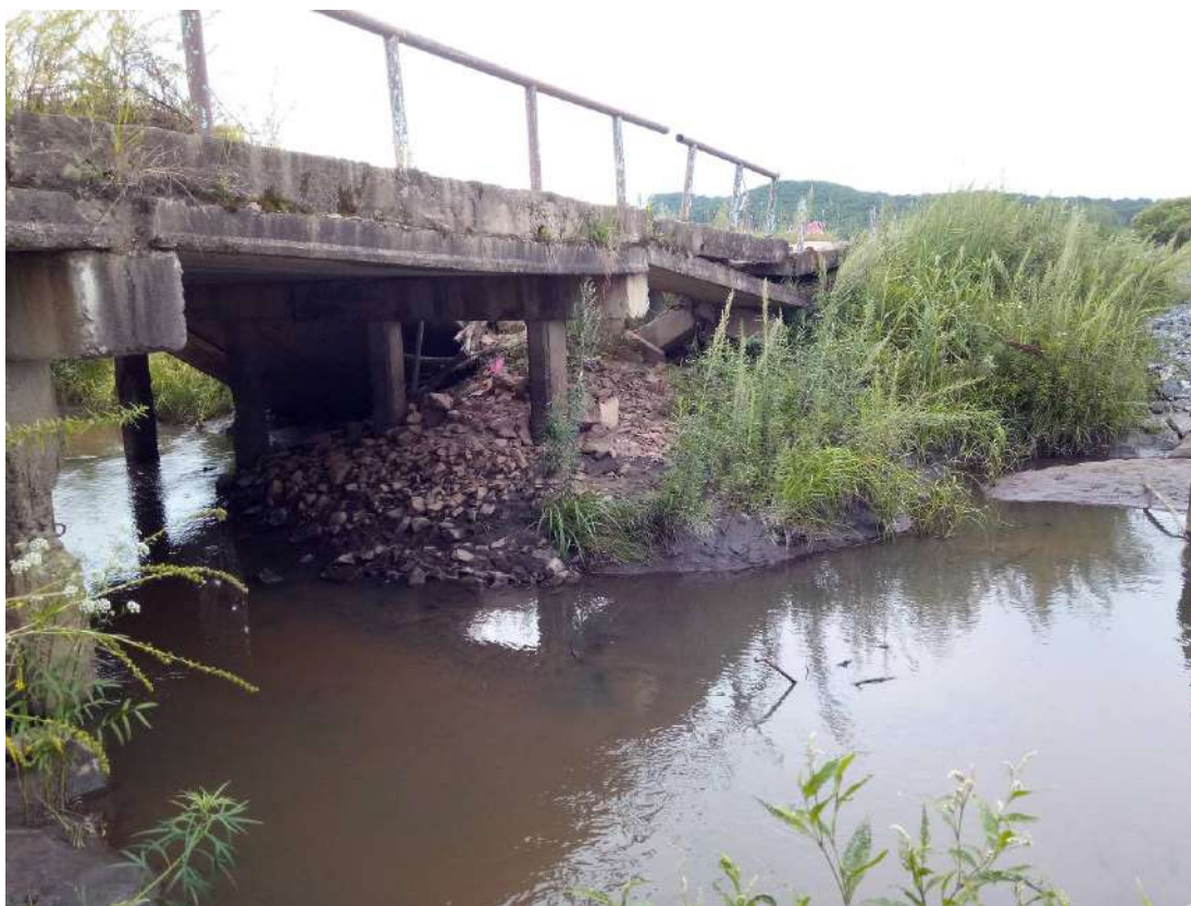
Фото 12. Нижний бьеф разрушенного моста через реку Кабанка. Вид вверх по течению (лето 2020 г).
