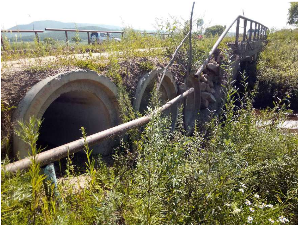
Фото 2. Верхний бьеф разрушенного моста через реку Кабанка. Вид в сторону правого берега (лето 2020 г.).
