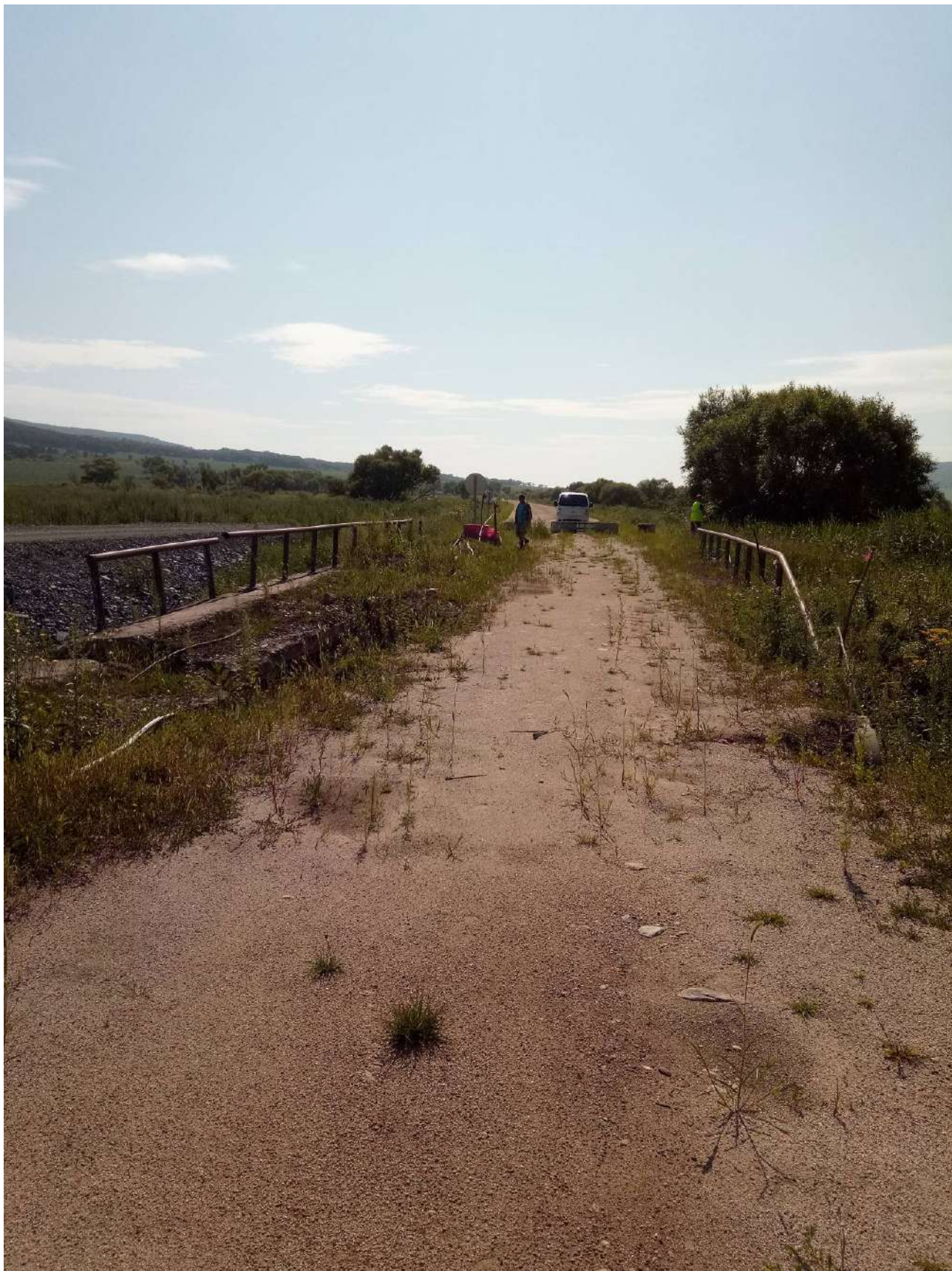
Фото 4. Проезжая часть разрушенного моста через реку Кабанка. Вид в сторону начала трассы (лето 2020 г).
