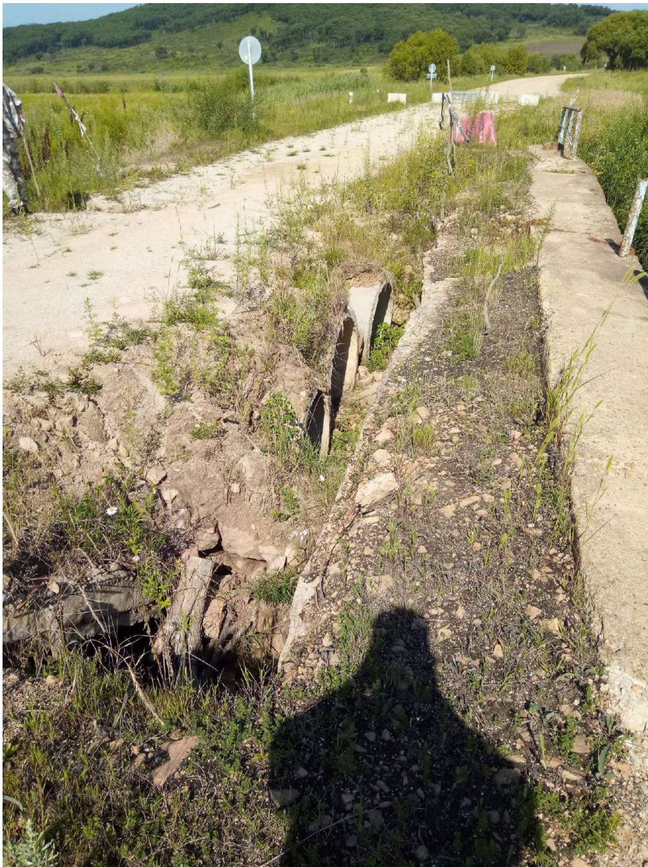
Фото 1. Разрушенный мост через реку Кабанка. Вид в сторону левого склона долины (лето 2020 г).
