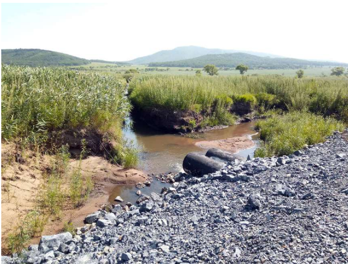
Фото 6. Русло реки Кабанка со стороны нижнего бьефа водопропускных труб на объезде разрушенного моста. Вид вниз по течению (лето 2020 г).
