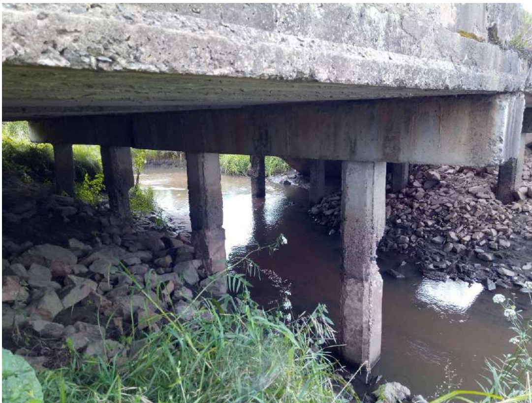
Фото 11. Русловые опоры разрушенного мостового перехода через реку Кабанка в районе 2 и 3 пролёта. Вид с правого берега (лето 2020 г).
