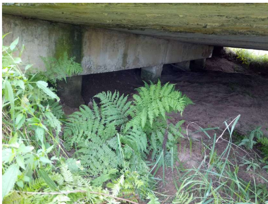
Фото 10. Береговая опора правого берега разрушенного мостового перехода через реку Кабанка. Вид вверх по течению (лето 2020 г).
