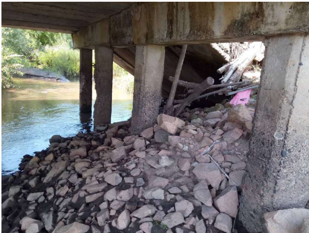
Фото 9. Руслловая опора разрушенного мостового перехода через реку Кабанка в районе 3 и 4 пролётов. Вид вверх по течению (лето 2020 г).
