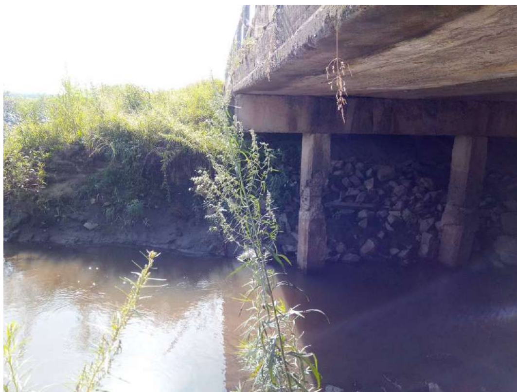
Фото 8. Подмыв правого берегового устоя под разрушенным мостом через реку Кабанка. Вид с левого берега (лето 2020 г).
