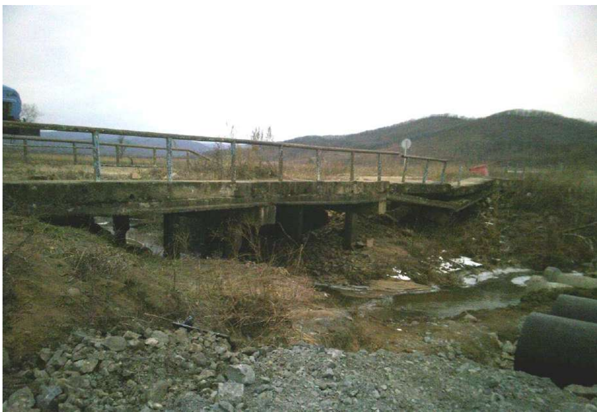
Фото 15. Нижний бьеф разрушенного моста через реку Кабанка. Вид вверх по течению (осень 2020 г).
