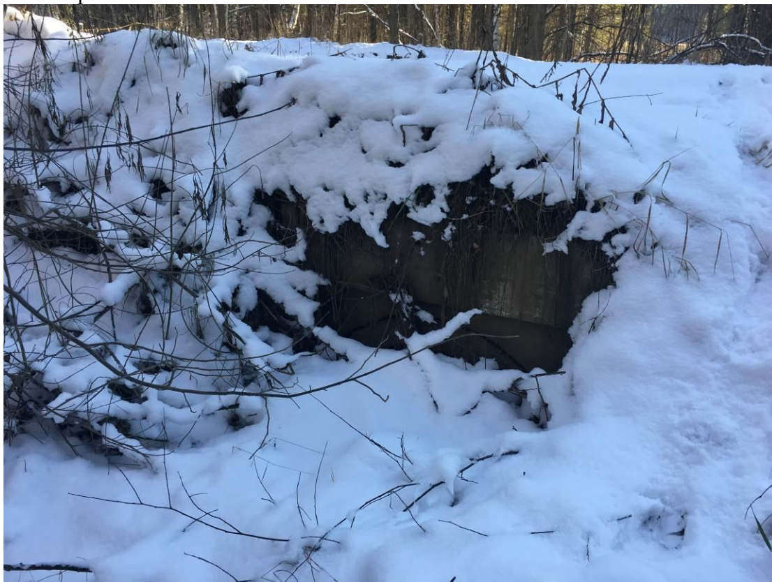
ПК 35+01 - Заваленное входное отверстие железобетонной трубы ( d = 1,0 м);
