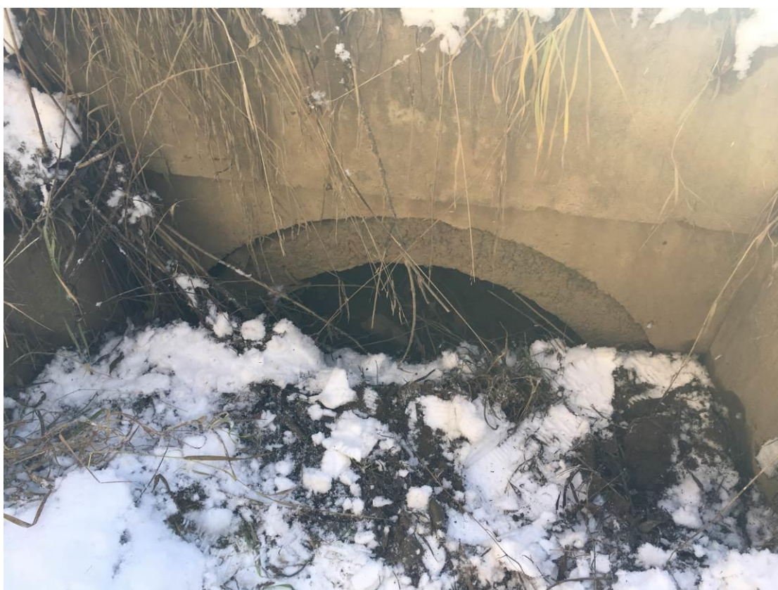
ПК 27+63 – Заваленное входное отверстие железобетонной трубы ( d = 1,0 м);
