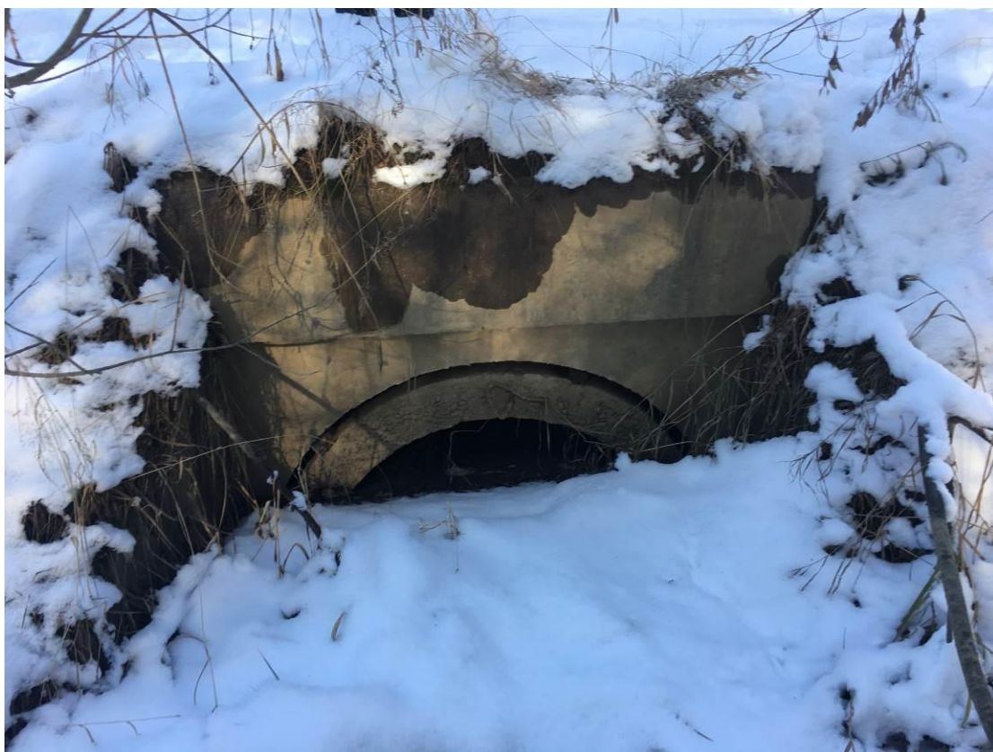
ПК 35+01 - Заваленное выходное отверстие железобетонной трубы ( d = 1,0 м);
