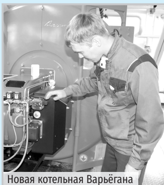
Новая котельная Варьёгана
