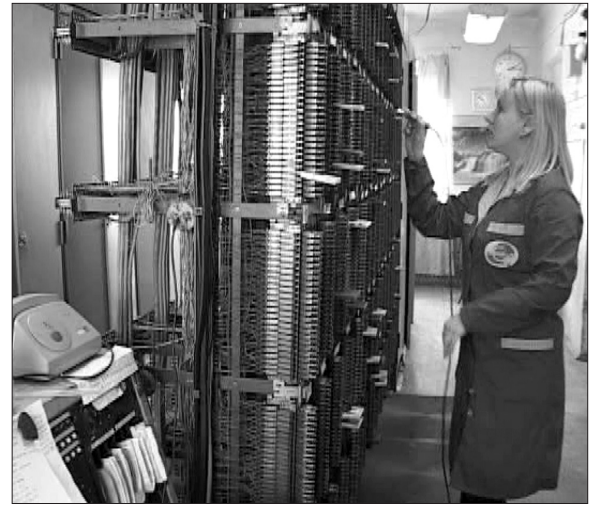
Автоматическая телефонная станция стационарной телефонной связи.
