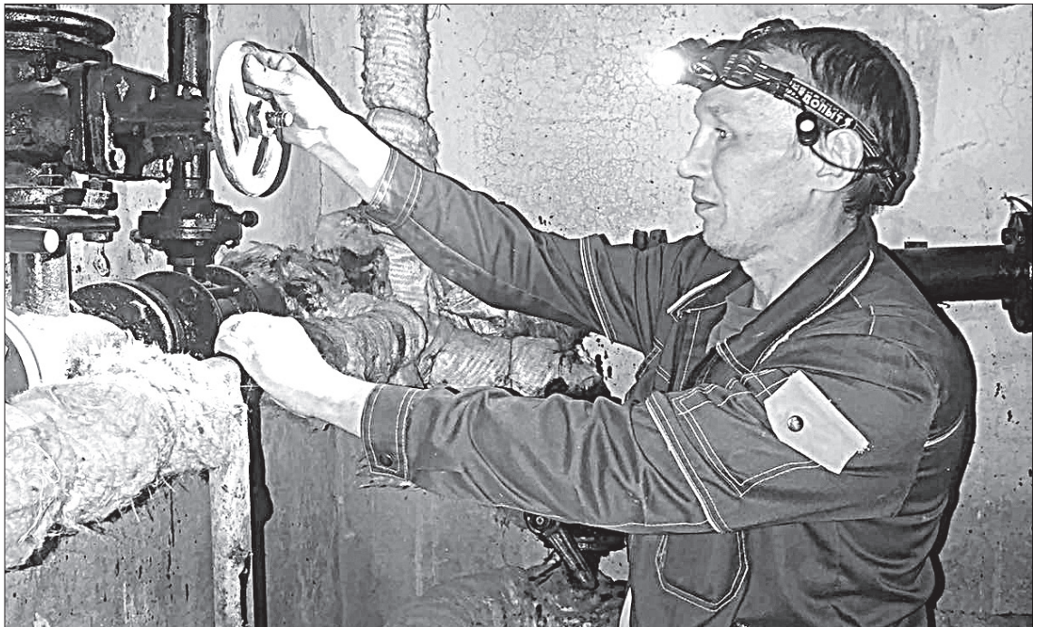
Летом городская система теплоснабжения проходит обязательное обследование.
