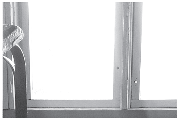
Рисунок 9.9. Одинарное остекление оконных блоков подъездов жилых домов
