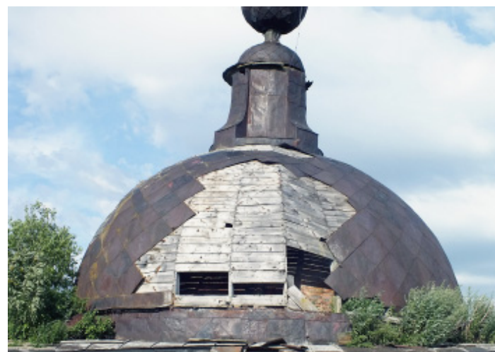
Купол нуждается в срочном ремонте.
