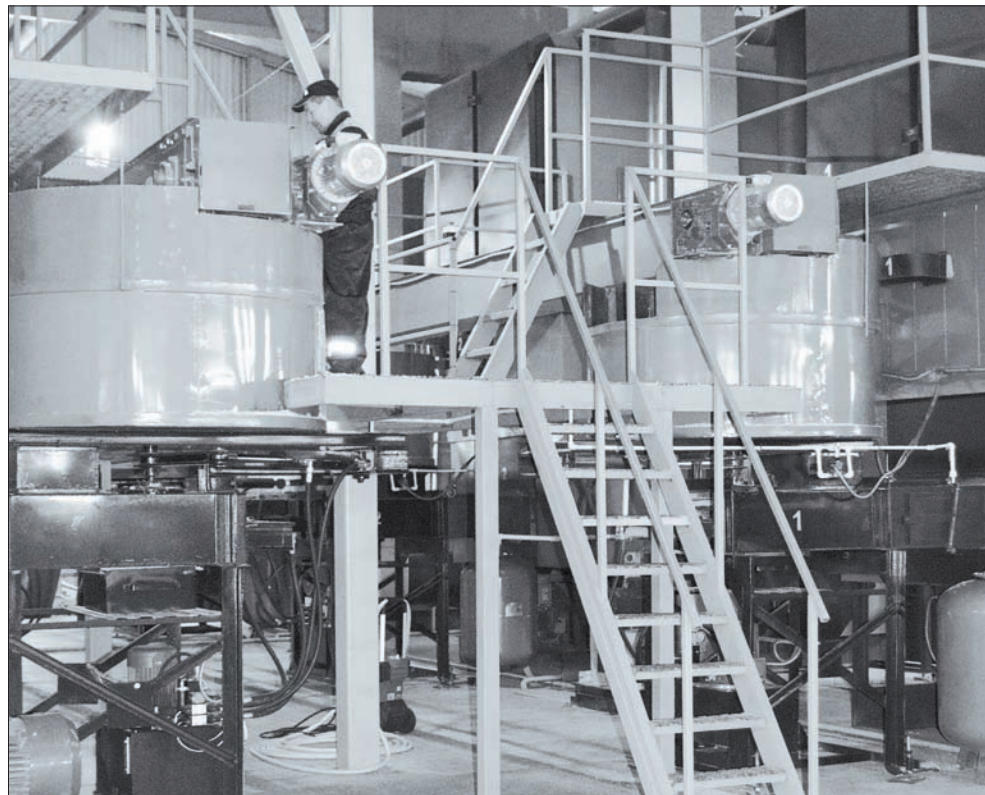
Котельная в Холмогорах подготовлена к началу нового отопительного сезона
