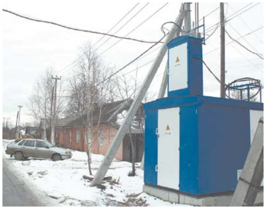
Новая подстанция на улице А.Харлова
