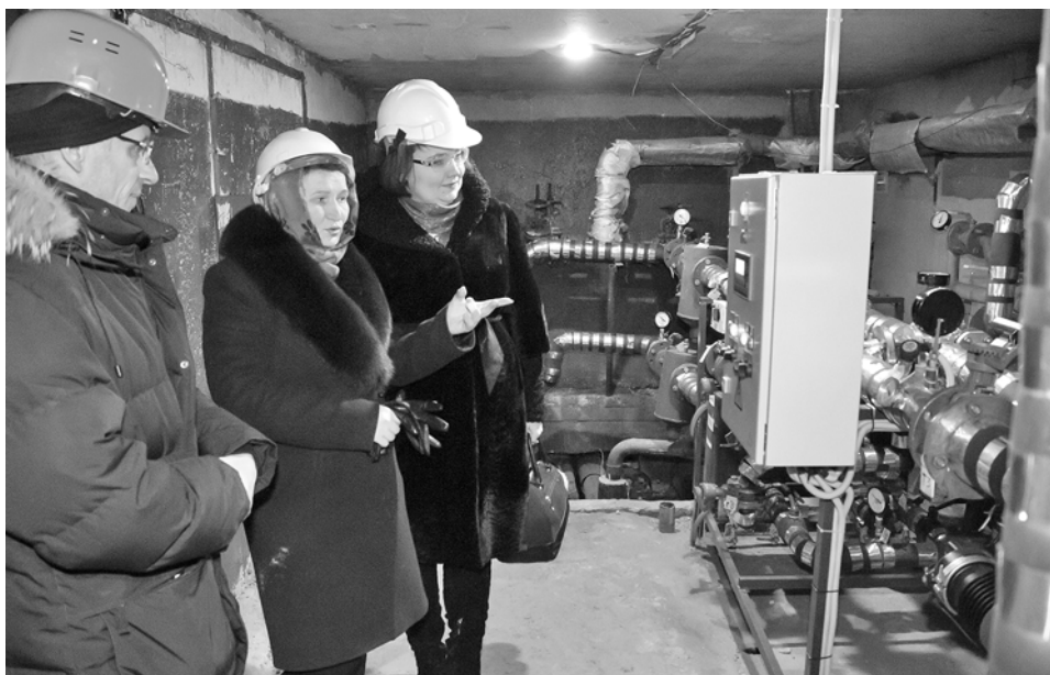
Муниципальный жилищный инспектор Мария Маринина и главный инженер управляющей компании «Наш дом» Ризиды Хазиева делают осмотр АИТП дома по адресу: Югорская, 20.
