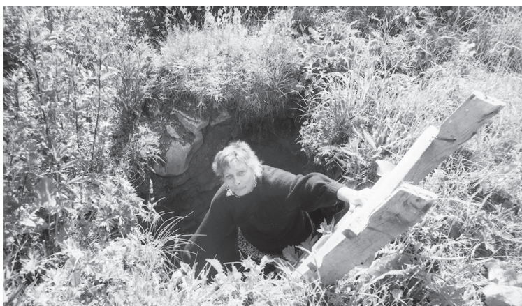
Конструктор института Спецпроектреставрация Татьяна Коних обследует провал на Восточном прясле
