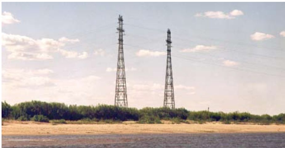
Воздушный переход ВЛ 110 кВ через реку Волгу
