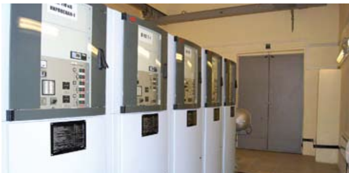
Подстанция «90 лет ГОЭЛРО». КРУЭ 110 кВ (ABB)
