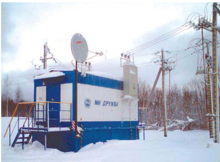
Блок-контейнер пункта контроля и управления линейной телемеханики БТС-2
