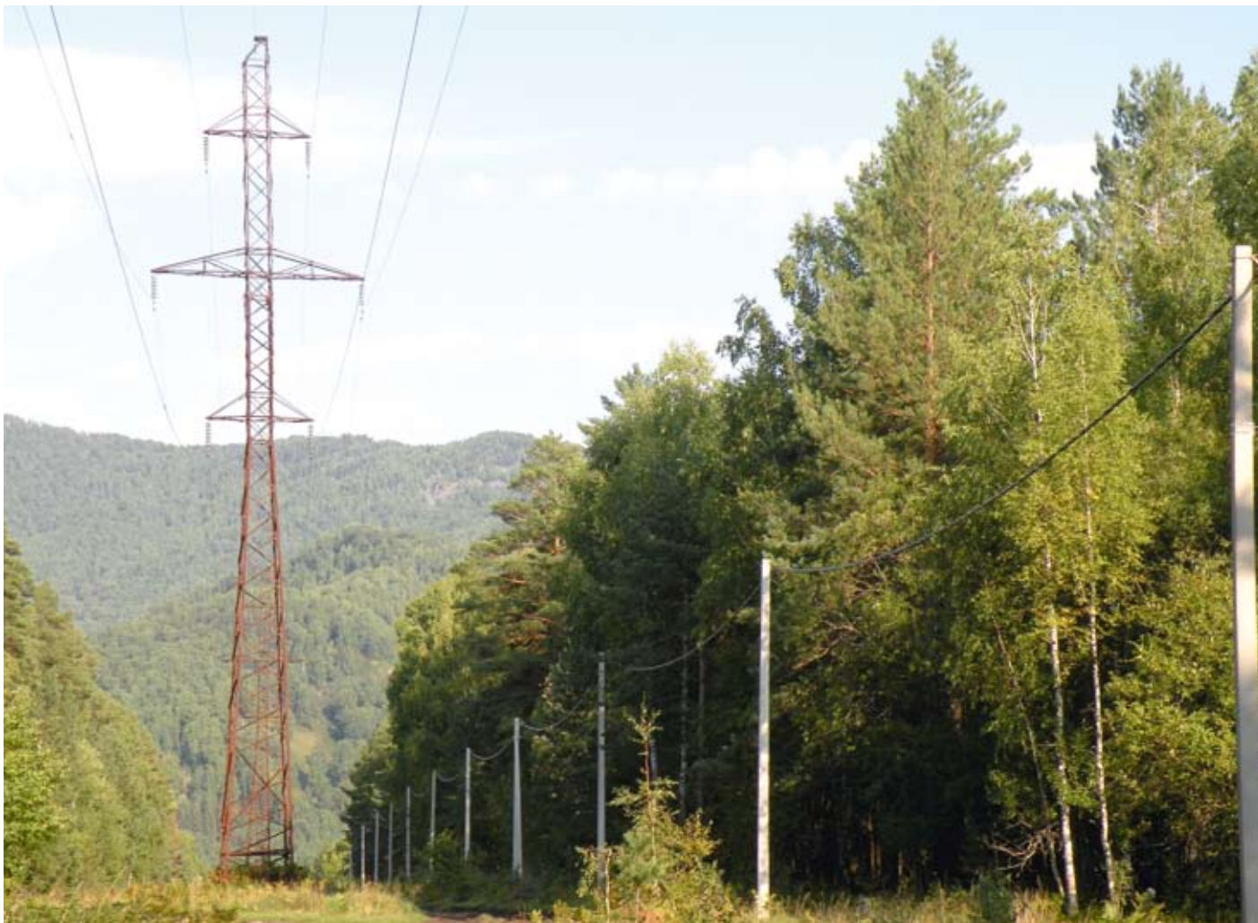
Электроснабжение строящегося горнолыжного комплекса «Манжерок» с использованием мультивиски
