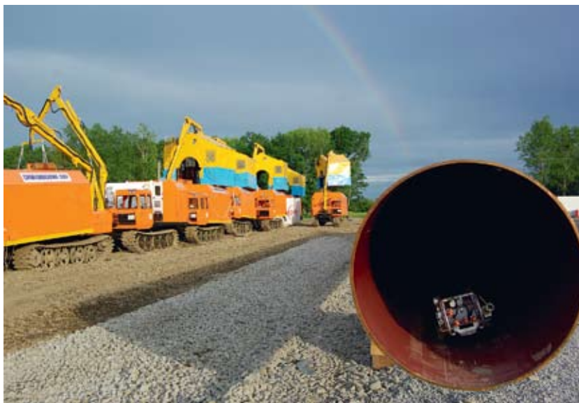
Автоматизированный сварочный комплекс
