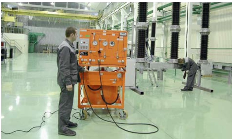
Подготовка к проведению приемо-сдаточных испытаний ВГТ-110
