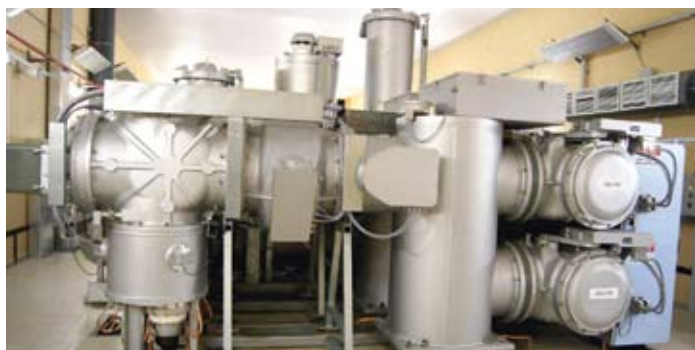
Подстанция «Петрищевская». КРУЭ 110 кВ (ABB)
