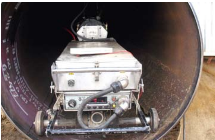
Кроулер GME-24, используемый для просветки трубопровода
