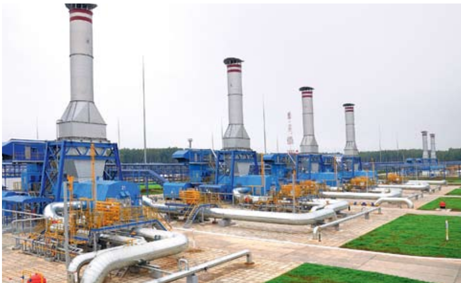
Площадка компрессорных агрегатов. КС «Ивановская»
