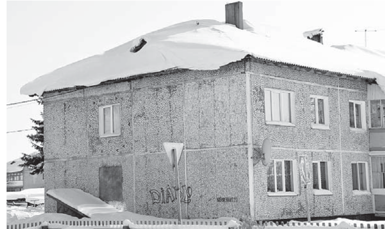
В этом доме надеются на прочность кровельной конструкции.
