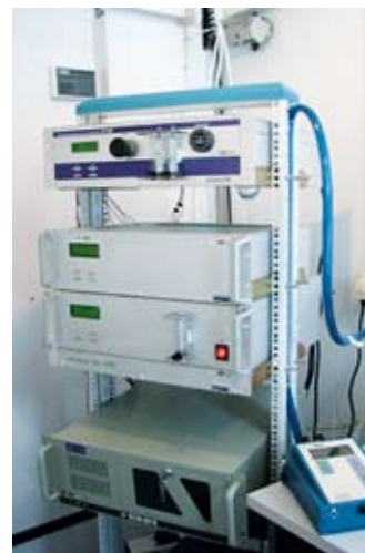
Внутреннее оснащение автоматической станции контроля над загрязнением атмосферного воздуха в Екатеринбурге
