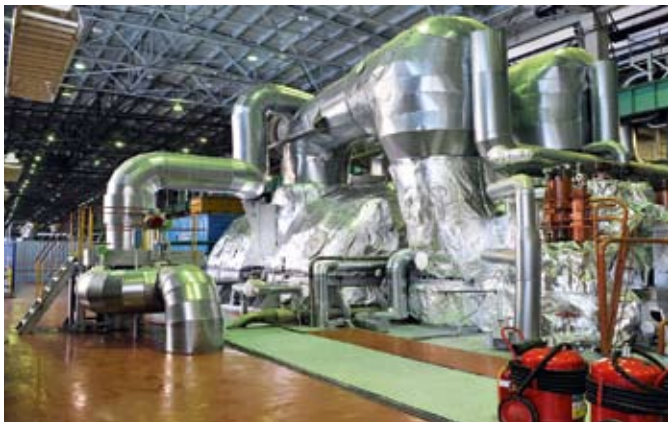
Энергоблок № 2 Тюменской ТЭЦ-1
