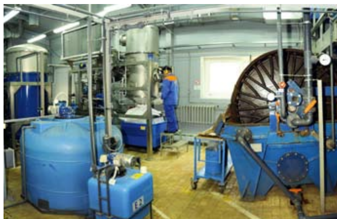
На участке ферритизации цеха металлопокрытий
