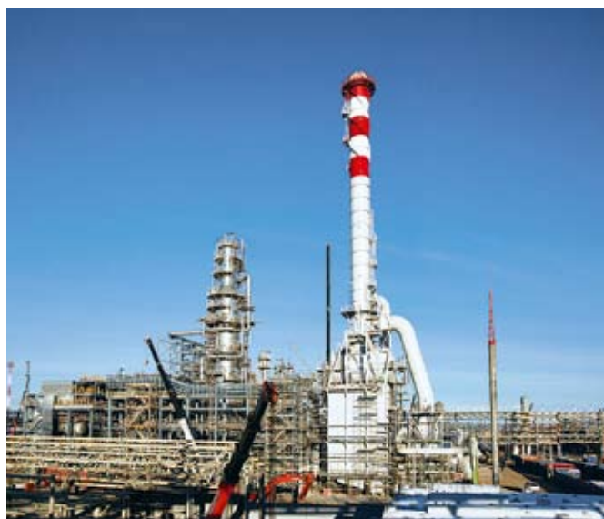
Третья установка по переработке нефти ЭЛОУ-АТ-3
