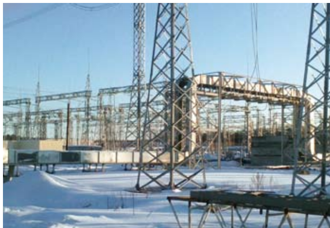
Эстакада электротехнических связей, совмещенная с технологическими трубопроводами Белоярской АЭС
