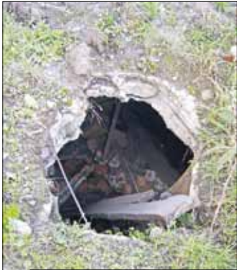
Не попадите в эту яму рядом с бывшей льнозаводской котельной!
