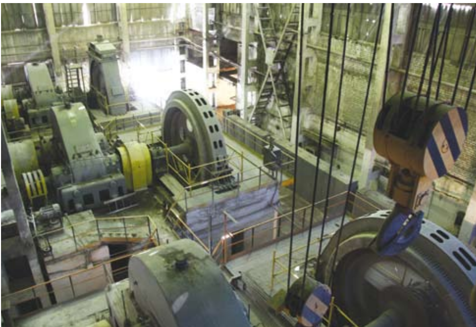
Редукторы цеха. ЗАО «Липецкцемент»
