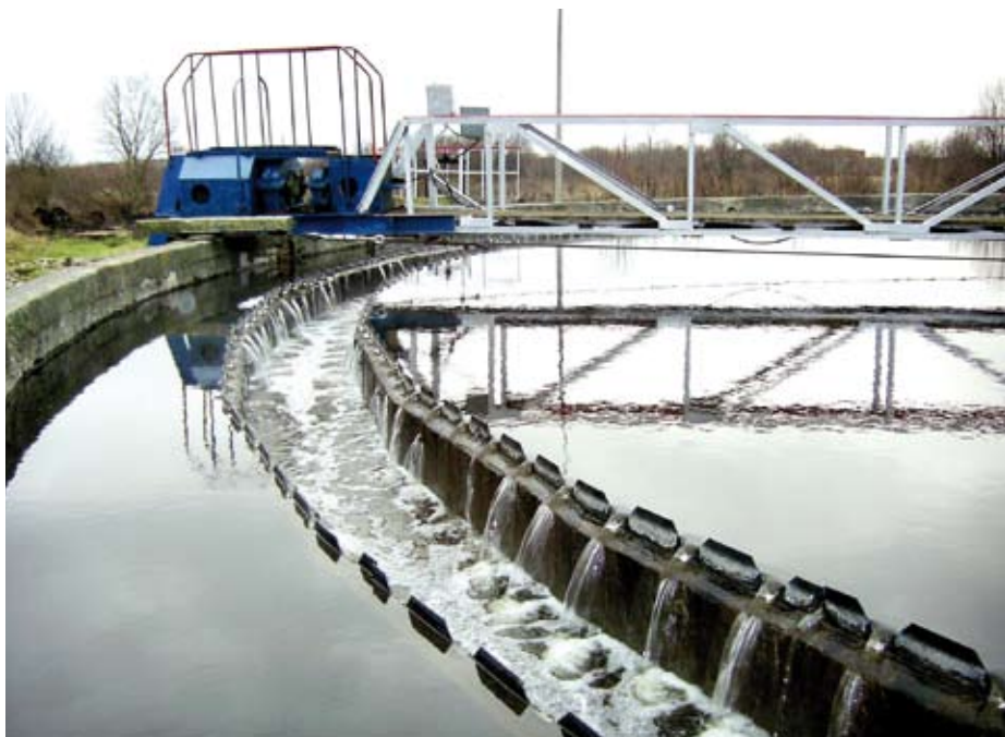
Очистные сооружения канализации
