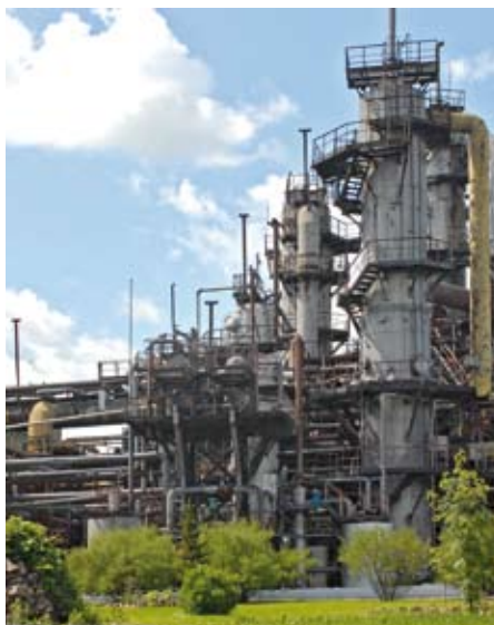
Установка по очистке коксового газа от аммиака круговым фосфатным способом
