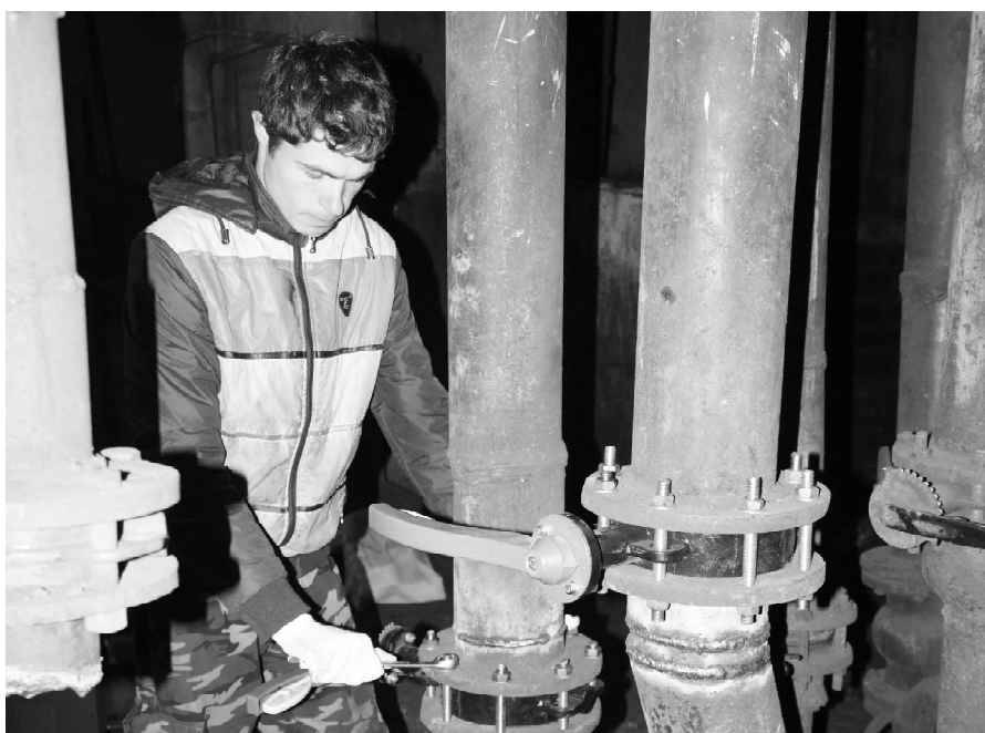
Никита Попов, молодой слесарь предприятия, делает финишные "штрихи" в центральной котельной.
