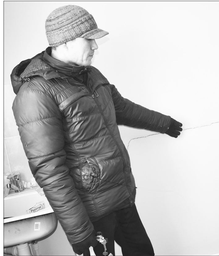
Стены в новой квартире пошли трещинами...
