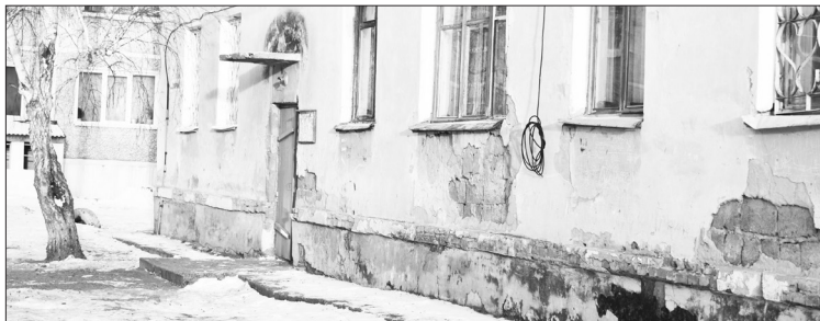
Этот дом был признан аварийным ещё в 2001 году.
